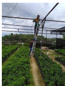
Gambar 67. Instalasi Sistem Irigasi
